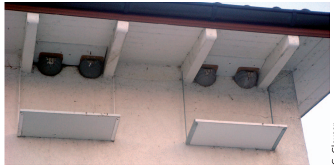
Abb. 14: Zur Schonung der Fassade werden Kotbretter wenn möglich mit Winkleisen am Dach aufgehängt. Ein Abstand zwischen den Kotbretter ermöglicht das Anstellen einer Leiter.
